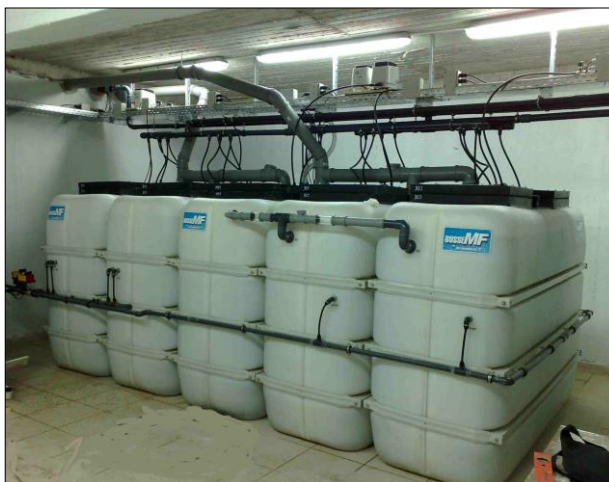
Kläranlage mit Mikrofiltration
