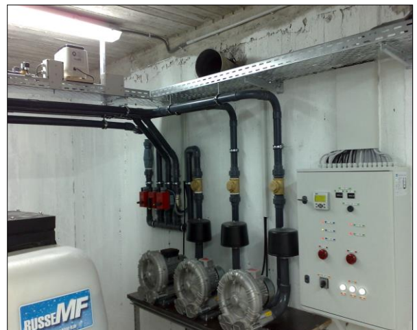
Verdichter zur Belüftung des Belebtschlammes
