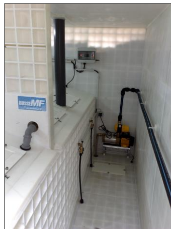
Kleinkläranlage Innenansicht, Speisepumpe
